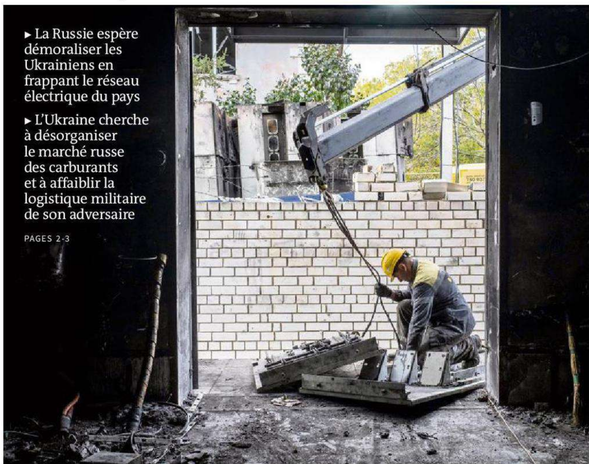
Des ingénieurs dans une sous-station électrique, après une attaque russe, à Odessa (Ukraine), le 23 octobre. V. NGUYEN HOANG/HL/HUMA POUR « LE MONDE »
